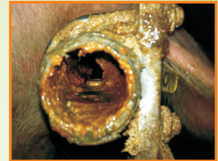
Zustand einer Tränkleitung im Schweinestall
