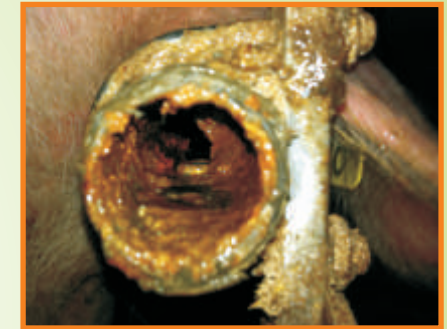
Estado de una tubería de agua en una explotación de Cerdos
