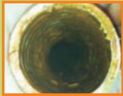
Depósitos de hierro y calcio en el interior de las tuberías
